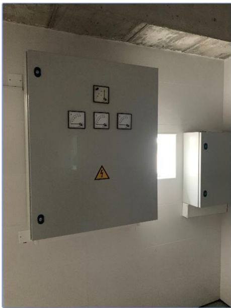
Imagen 58 Ejemplo de cuadro eléctrico general
