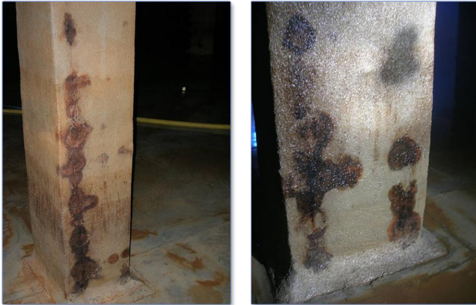
Imagen 139 Corrosión de armaduras en pilar y expulsión de recubrimiento de hormigón
