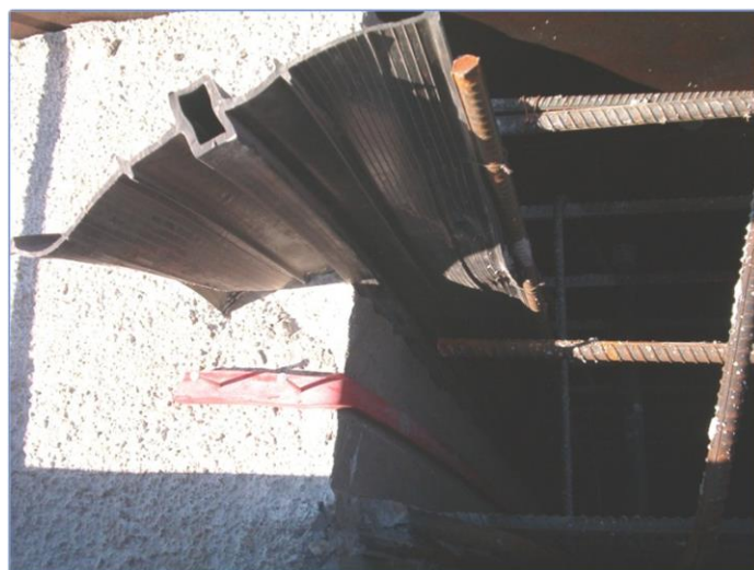
Imagen 109 Ejecución de juntas entre paneles verticales perimetrales (water-stop e hidrófila hacia el paramento exterior)
