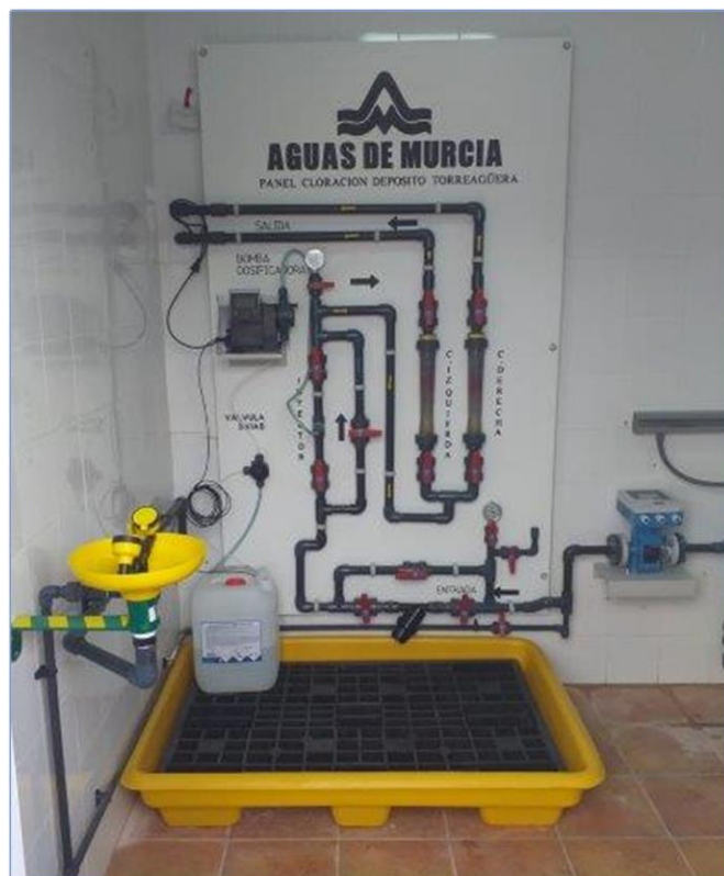
Imagen 49 Panel de cloración en depósito existente
