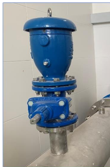
Imagen 15 Ejemplo de ventosa trifuncional instalada en tubería de salida de una de las cámaras
