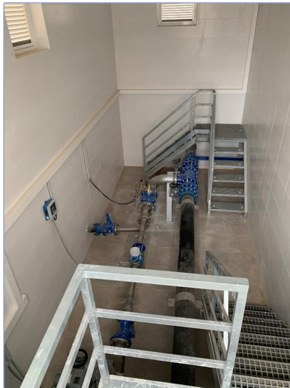
Imagen 48 Ejemplo de acabados en sala de válvulas de entrada
