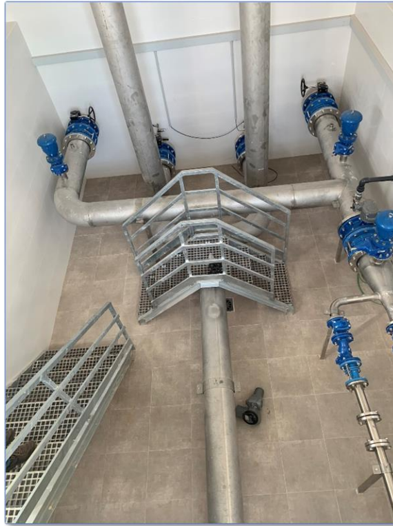
Imagen 47 Ejemplo de acabados en sala de válvulas de salida
