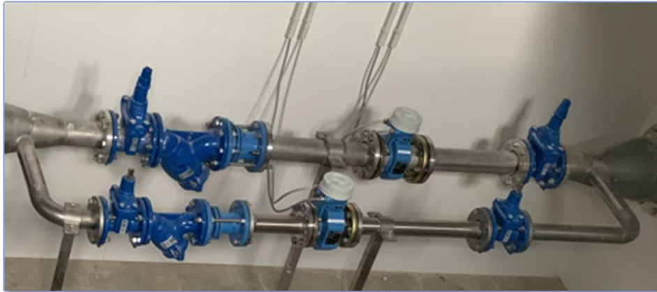
Imagen 17 Instalación típica de caudalímetro en tubería de salida situado en depósito existente
