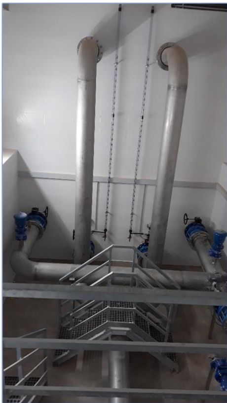
Imagen 40 Sala de válvulas salida
