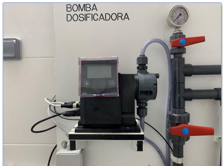
Imagen 51 Bomba dosificadora hipoclorito
