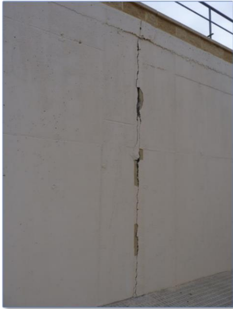
Imagen 136 Fisura transversal en depósito de agua potable
