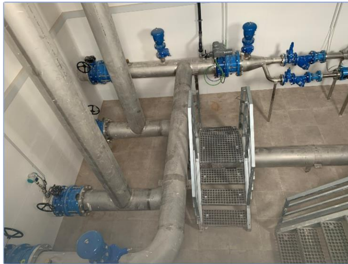
Imagen 43 Ejemplo de pasarela de acceso a distintas zonas de la sala de válvulas de salida
