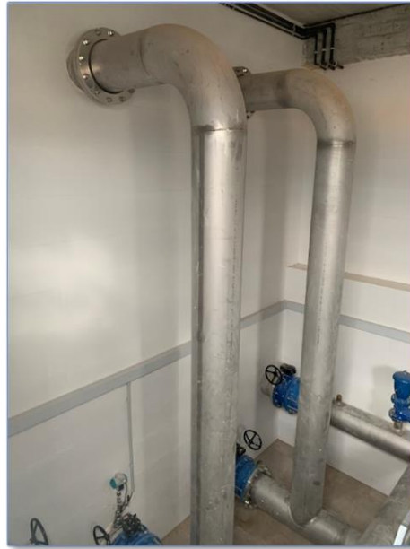
Imagen 24 Detalle de aliviaderos de las cámaras. Sala de válvulas de salida
