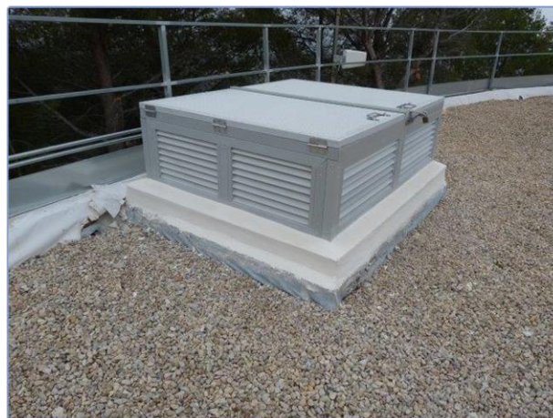
Imagen 39 Arqueta de PRFV para visualización desde cubierta.
