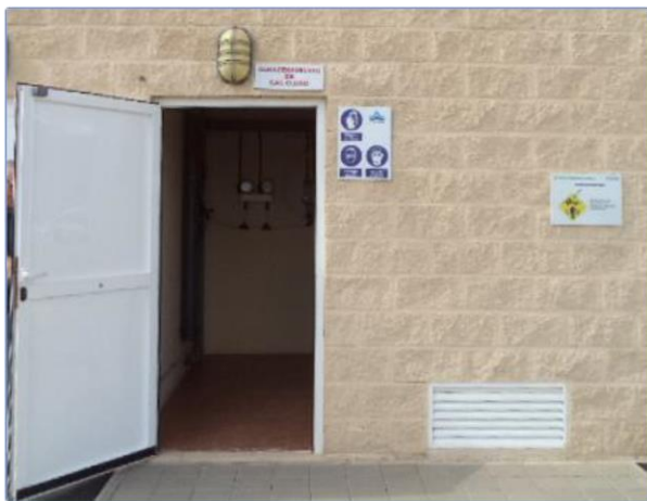
Imagen 77 Ejemplo de puerta de acceso a sala y señalización de seguridad
