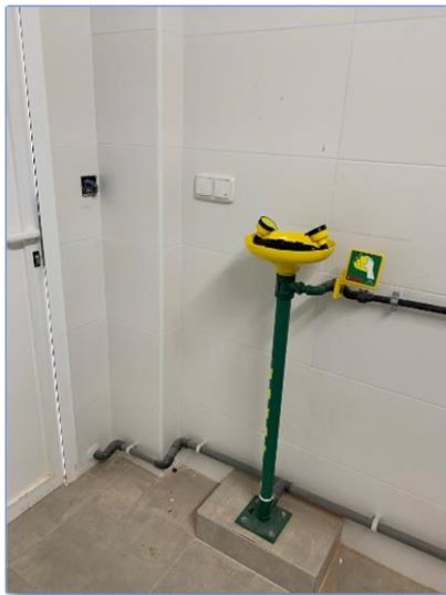
Imagen 50 Lavaojos ubicado en sala de cloración
