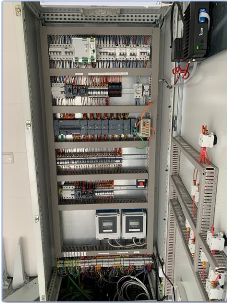
Imagen 60 Ejemplo de interior de armario telemando
