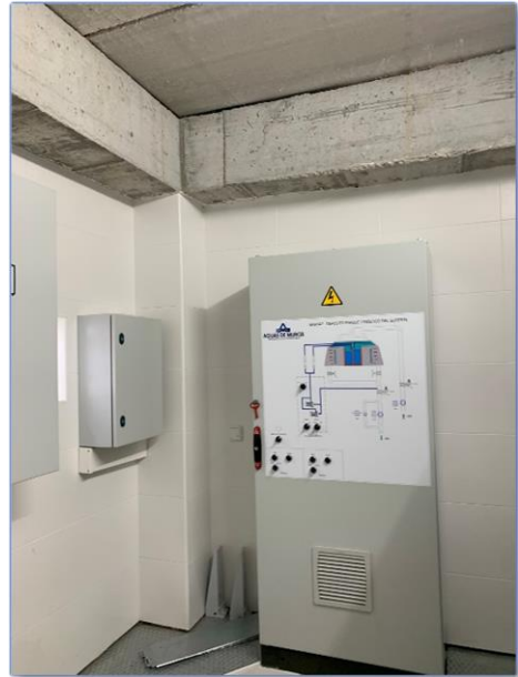
Imagen 57 Ejemplo de armario para cuadro de telemando
