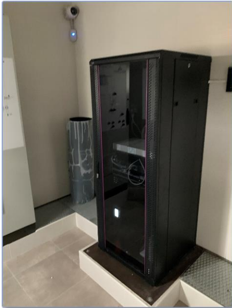
Imagen 56 Ejemplo de armario para el sistema de seguridad
