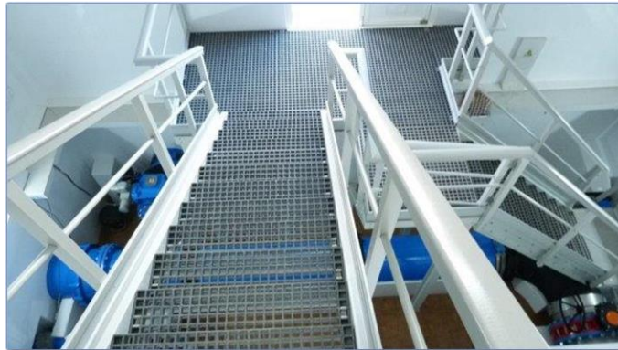
Imagen 45 Ejemplo de escaleras acceso a sala de válvulas en PRFV
