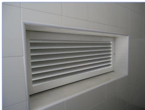
Imagen 36 Detalle interior de acceso a cámaras, ventilación.
