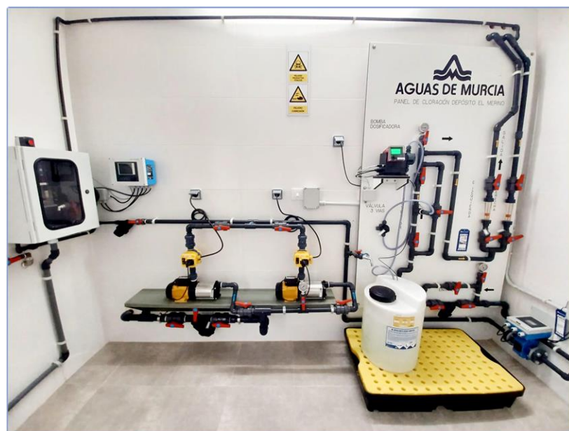
Imagen 52 Ejemplo de circuito de cloración en depósito existente
