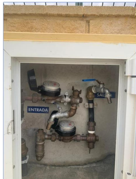
Imagen 81 Detalle interior de armario para toma de muestras de las tuberías de entrada y salida
