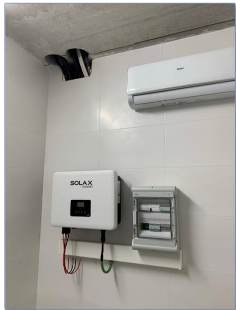
Imagen 59 Ejemplo de sistema de AC, inversor y cuadro de protección de instalación fotovoltaica
