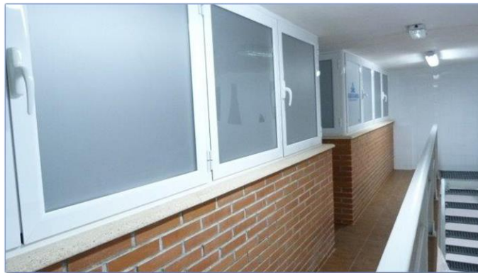
Imagen 38 Cerramiento de aluminio para visualización desde cámara de válvulas
