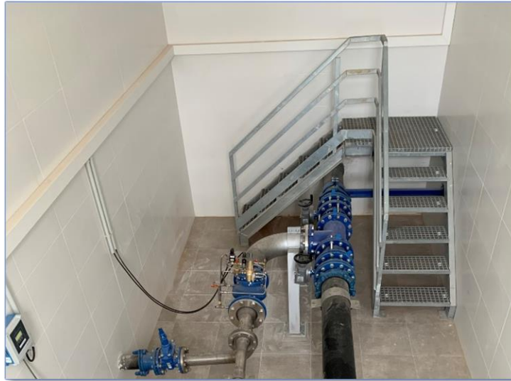
Imagen 44 Ejemplo de pasarela de acceso a distintas zonas en sala de válvulas de entrada
