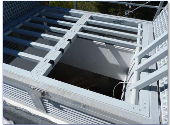
Imagen 71 Ejemplo de barras de protección bajo las tapas en huecos en cubierta
