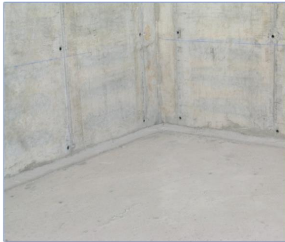
Imagen 27 Encuentro muros - losa
